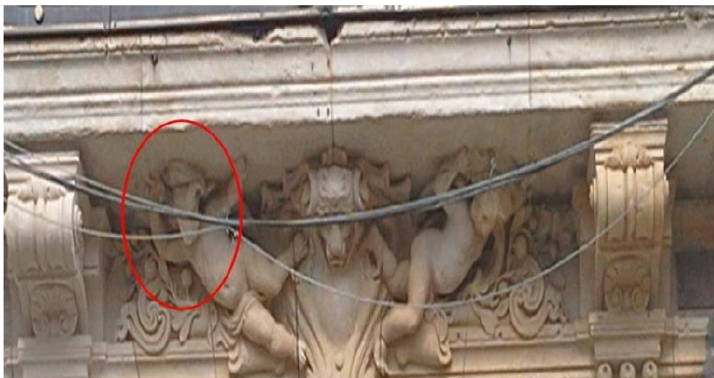
Figure. 4 : État de la façade de l'hôtel de ville, après l'opération de sablage (perte des caractères morphologiques du putti). , source : L'auteur, 2012.
