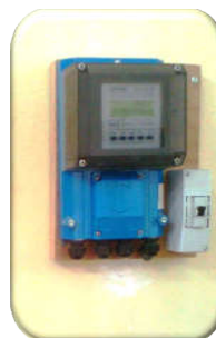
Photo7: convertisseur du débitmètre électromagnétique
