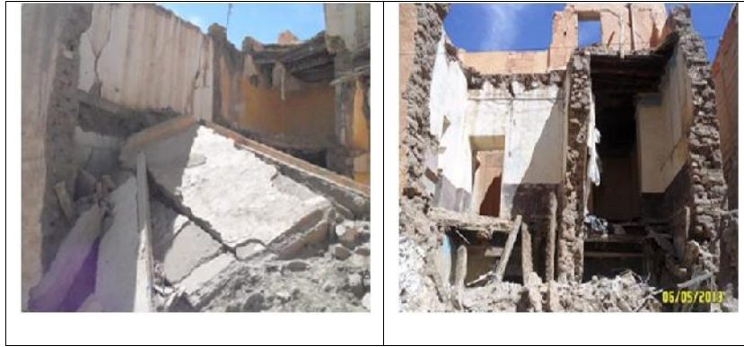
Fig.3. Effondrement totale d'un bâti [5].
