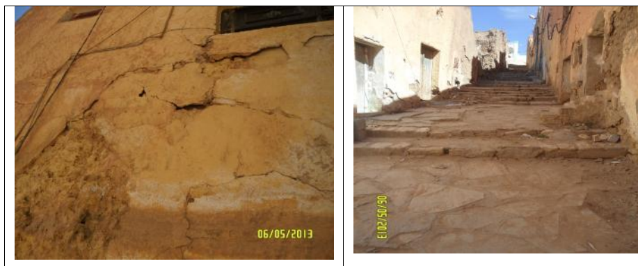
Fig.2. fissuration profondes et désintégration des enduits des façades [5].
