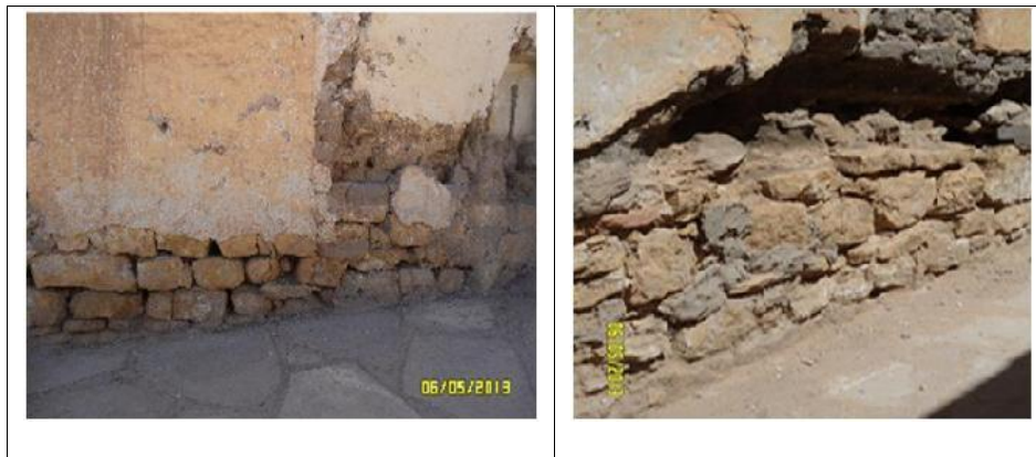
Fig.4. Détérioration de parties inférieures des murs (pierre délitée) [5].
