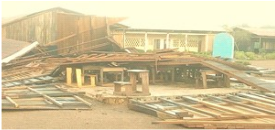
a. Le lycée de Sambo à Batouri sinistré à l'EST du pays, juillet 2019 ©actucameroun.com
