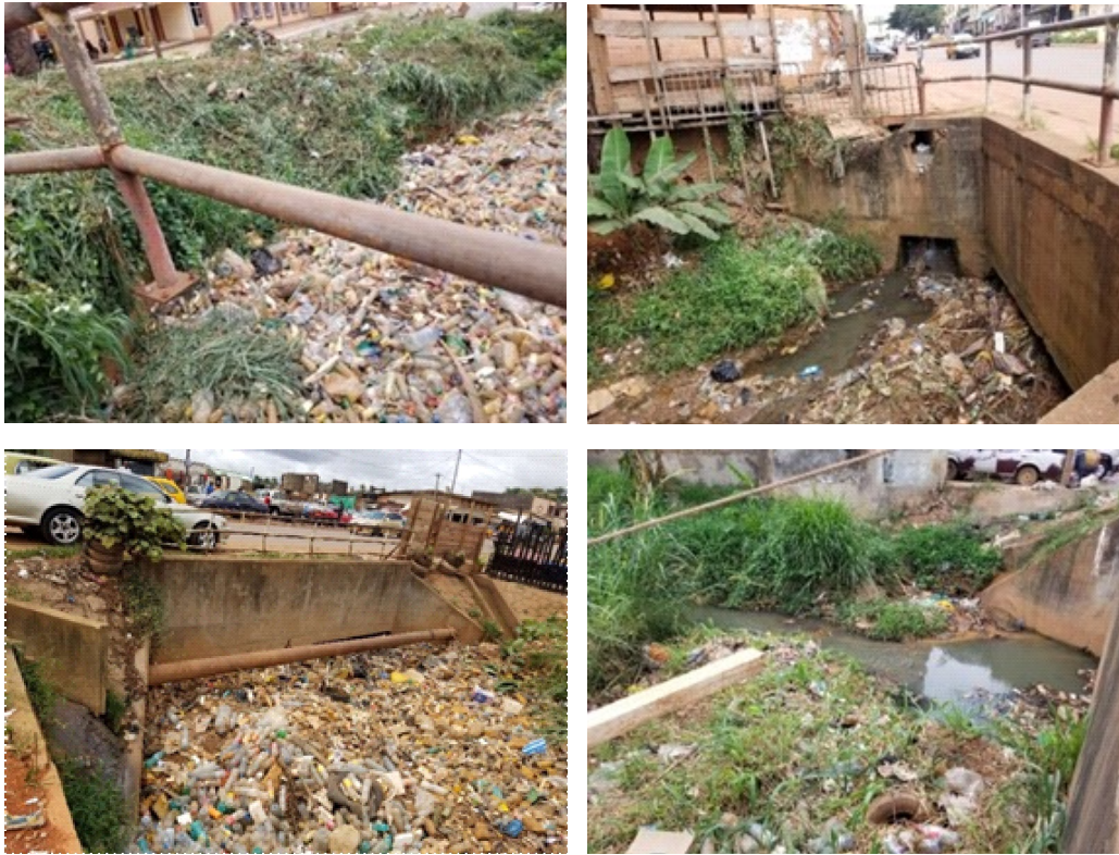
Figure 6 : Illustrations photos de l'obstruction du drain par les déchets solides, à Acacia Yaoundé
