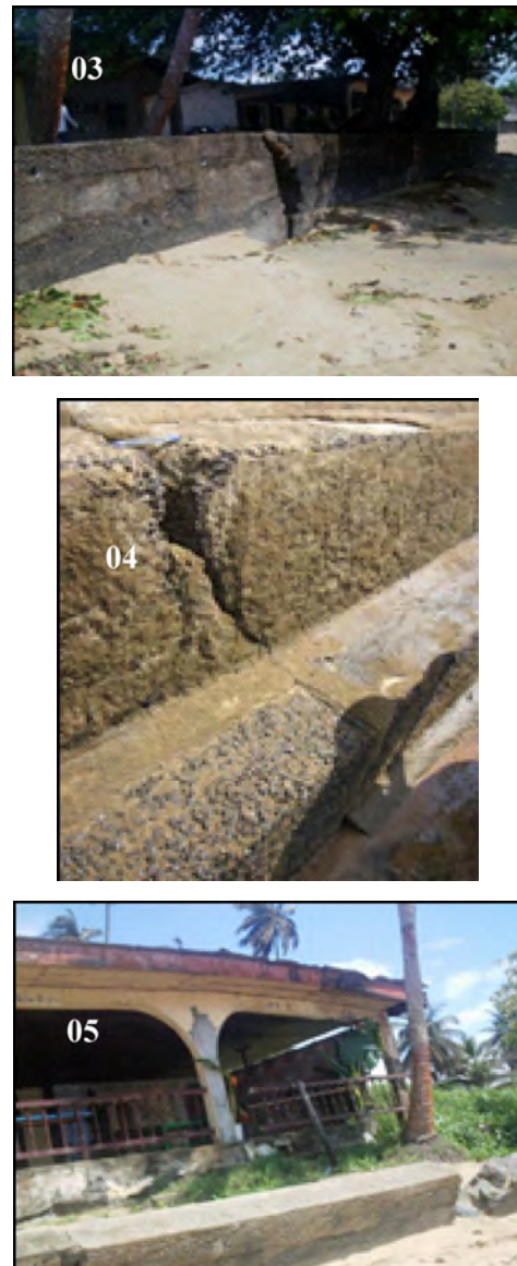
Fig.7 : Photo 03, 04, 05 : Le risque d'effondrement des infrastructures.
