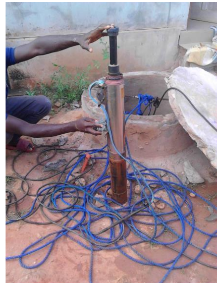
3d Entretien d'une pompe de forage
