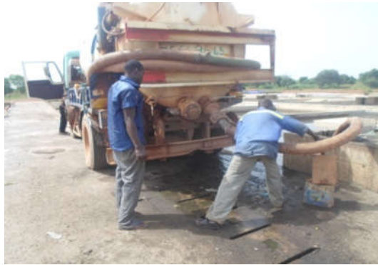
Figure 3: vidange mécanique sur les lits de séchage.
