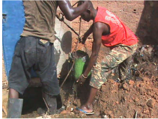
Figure 2 : Vidange manuelle d'une latrine familiale.
