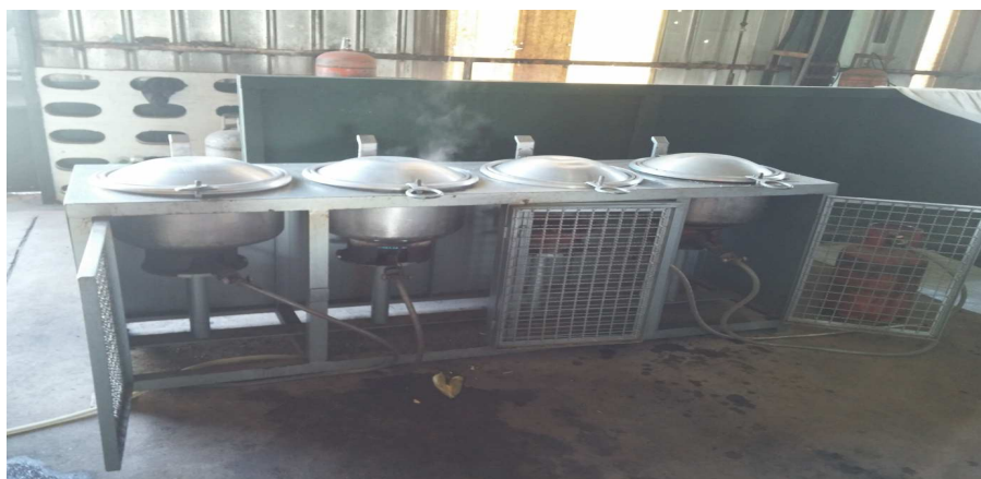
Figure 8 : Batterie de quatre cuiseurs en batch alimenté au gaz butane.
