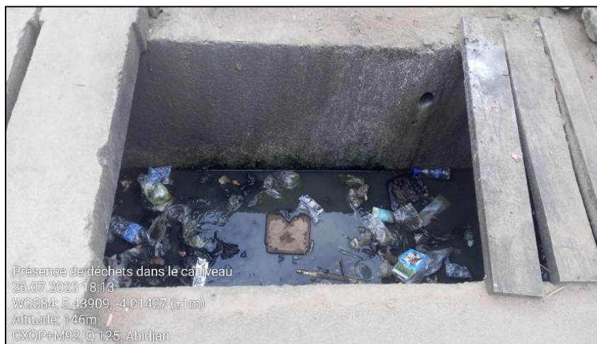
Photo 2 : un caniveau obstrué par des ordures
