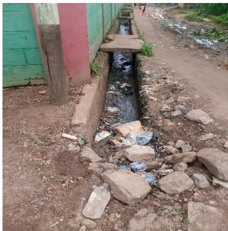
Photo 2 : un caniveau à Kara un transformé en décharge
