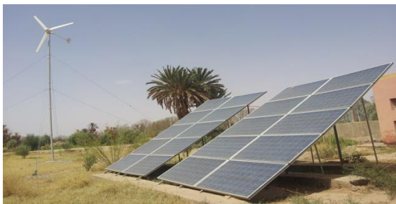
Photo 2. Panneaux solaires dans la coopérative Salmia
