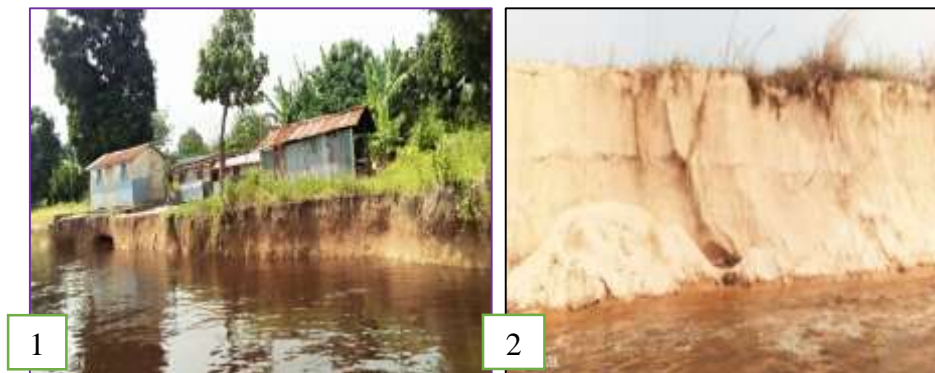
Photo n°1 : Erosion des berges menaçant les habitations à Mbamou centre. Photo n°2 : Eboulement observé au niveau d'une berge aux alentours du village Lissanga (Prises de vues : R.G. Londessoko Dokonda, 2022)
