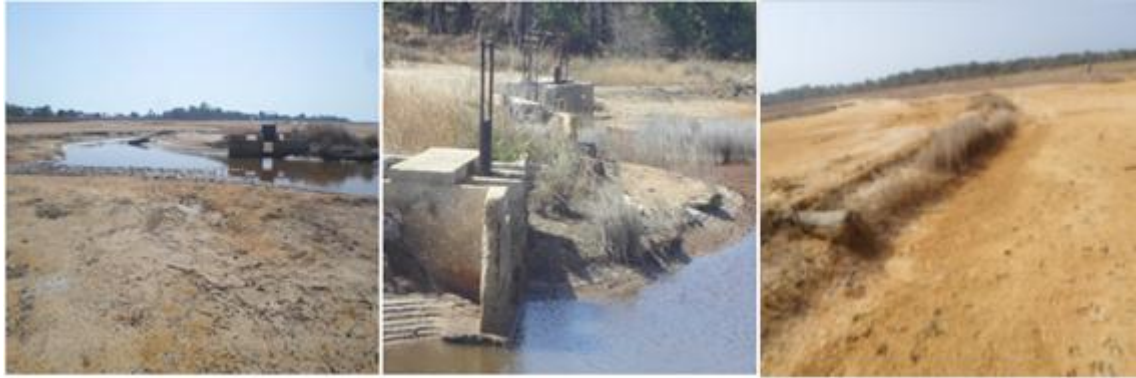
Photo 4 : Rupture d'une digue et intrusion des eaux salées dans les rizières (gauche), abandon des ouvrages modernes (centre) et digue de protection traditionnelle abandonnée (droite) à Kafone.
