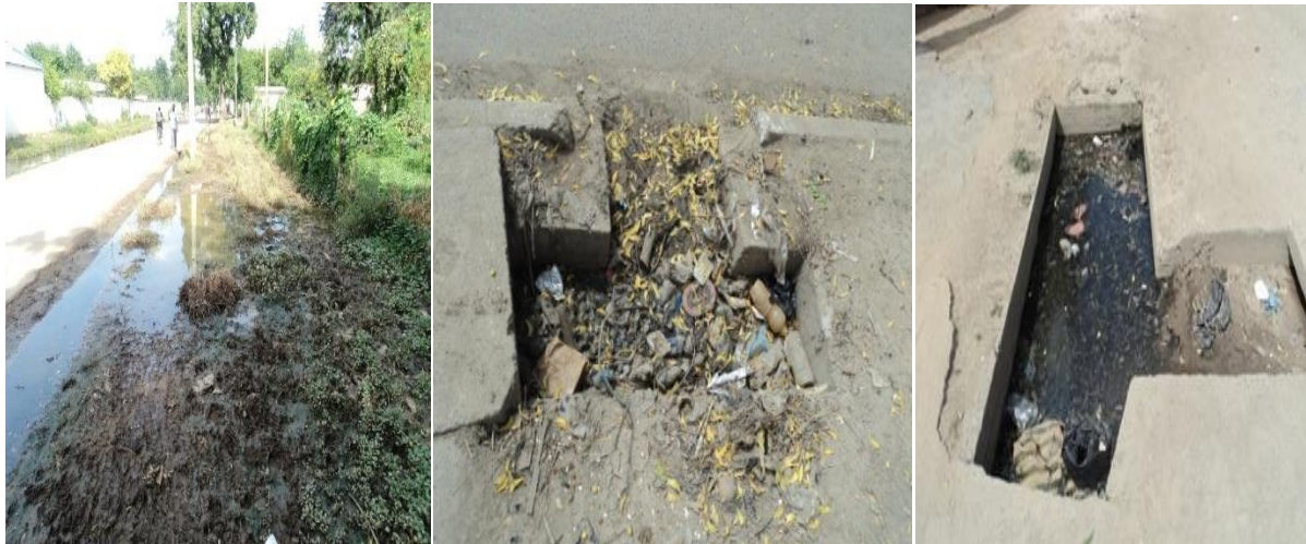
Photo 1 : Etat des drains dans la ville de Maroua en saison pluvieuse
